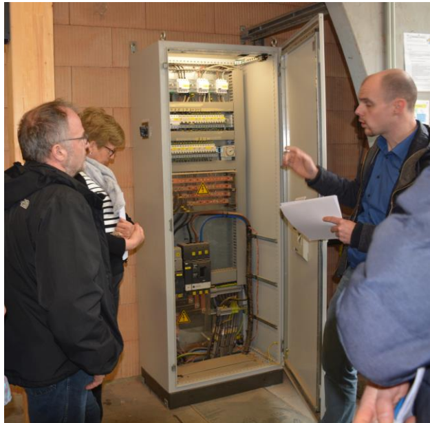
Foto van een studiedag over elektrische installaties in het Don Bosco Technisch Instituut Halle op 21 maart 2017.
